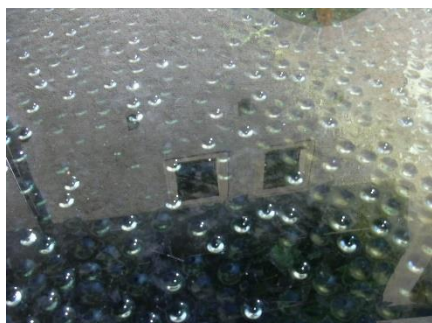
Studna u kostela je netypicky překryta sklem. Kapky pod ním značí 100% vlhkost.
