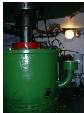
V útrobách elektrárny pod generátory
